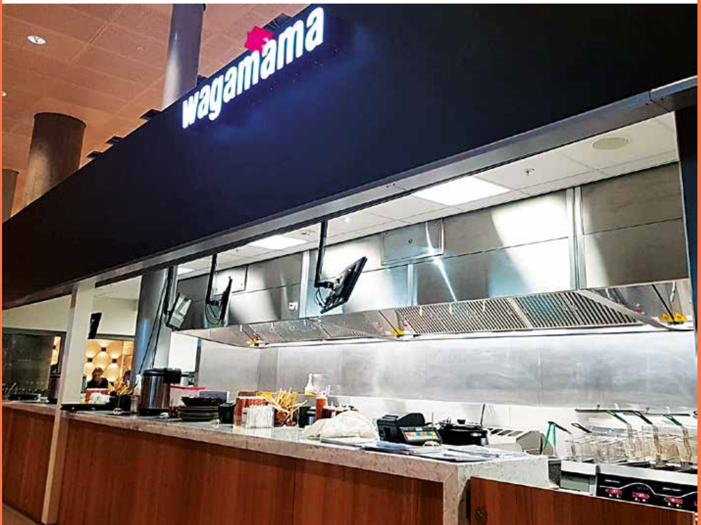
Kro Effekt Kjøkkenhette montert på Oslo Lufthavn Gardermoen, Wagamama.
